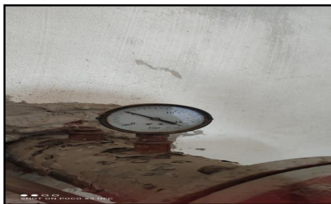
Corrosion considérable des conduites
