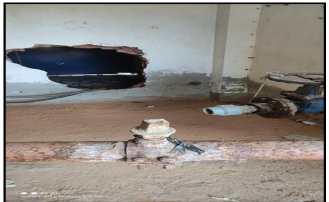
Câble électrique non protégé
