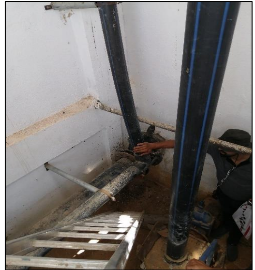
Figure 2.9 : Etat extérieur du réservoir N°3
