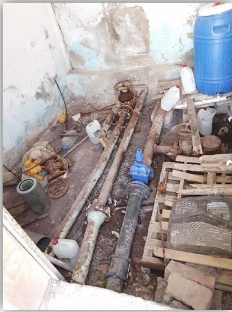
La chambre du vanne Réservoir 150
