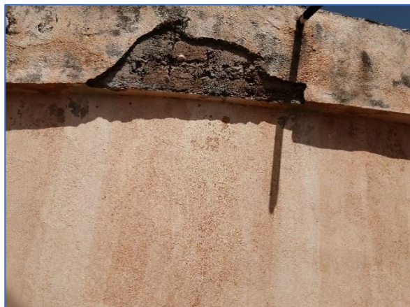
Figure 2.6 : Etat extérieur de réservoir N°2
