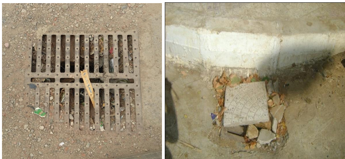
Figure II.4: Les bouches d'égouts colmatées. Source : ( DRE de Medea.2024)
