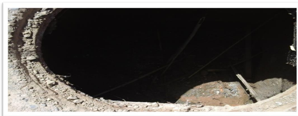
Figure II.3: État des regards de la commune D'Ouled Antar. Source : ( DRE de Medea.2024)
