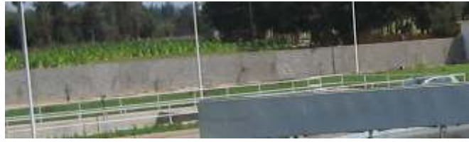
Photo 12 : Bassin de chloration de la STEP de la ville de Hadjout
