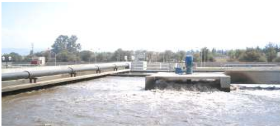
Photo 9 : Compartiment Aérobie - Traitement biologique - de la STEP de la ville de Hadjout
