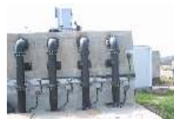
Photo 4 : Station de relevage de la STEP de la ville de Hadjout
