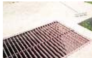
Photo 3 : Dégrillage grossier de la STEP de la ville de Hadjout
