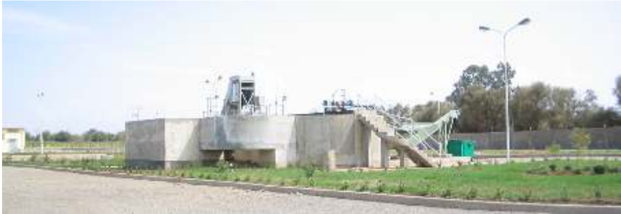
Photo 2 : Bloc des traitements physiques (dégrillage grossier et fin ainsi que dessablage / déshuilage) de la STEP de la ville de Hadjout
