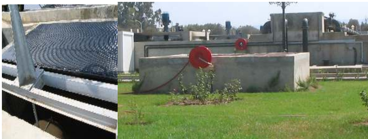
Photo 11 : Poste de pompage des boues (à gauche) et un bassin d'équilibre (chambre de distribution) pour la répartition des eaux vers les deux décanteurs (à droite) de la STEP de la ville de Hadjout
