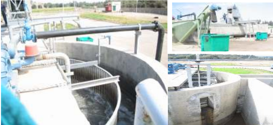
Photo 6 : Dessablage / déshuilage de la STEP de la ville de Hadjout
