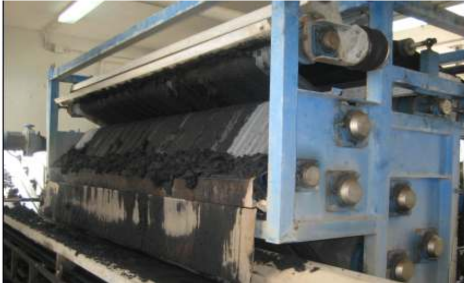
FigV-6 : Ouvrage d'épaississement de la station d'épuration de Réghaia
