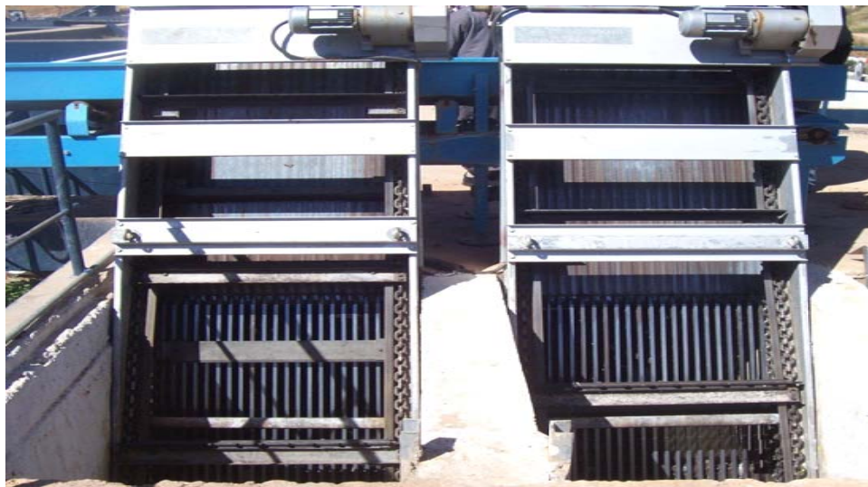
Figure IV-2 : Grilles mécanisées fines de la STEP de la ville de B.B.A
