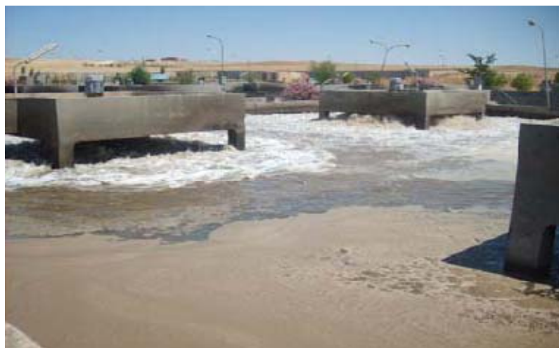
Figure IV-5 : Bassins d'aération de la STEP de la ville de B.B.A
