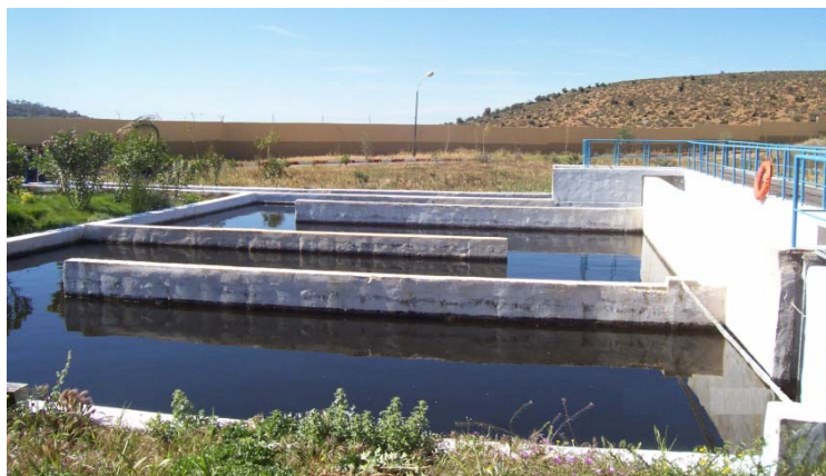
Figure IV.6 : Bassin de chloration de la STEP de la ville de B.B.A
