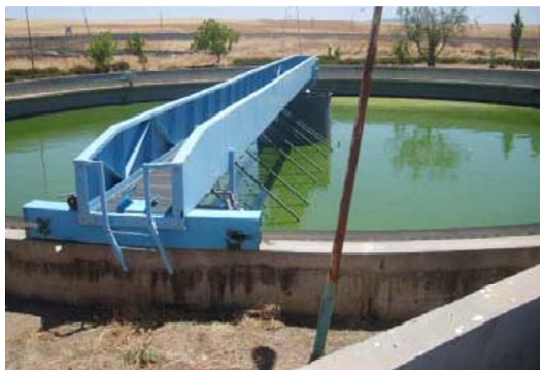
Figure IV-4 : Décanteur primaire de la STEP de la ville de B.B.A
