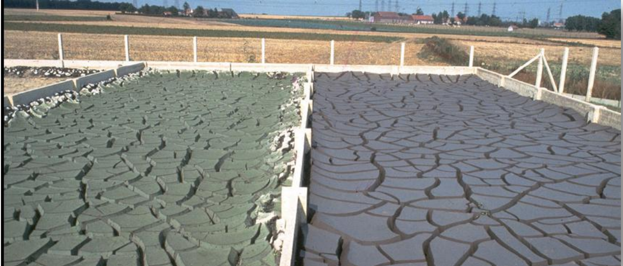
Fig N°III-19 :Lit de séchage des boues.
