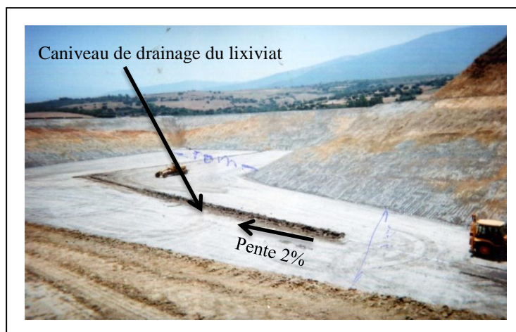
Fig.18. Drainage du lixiviat du casier [43]
