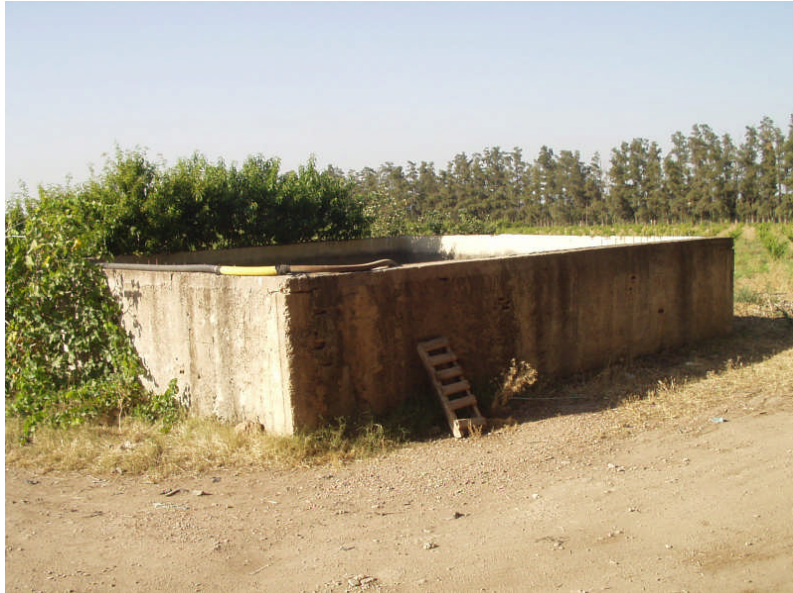
Figure (V-2) : La bâche d'eau.
