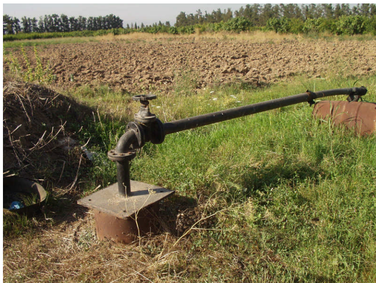
Figure (V-1) : Le forage en place et la conduite qui lui est raccordée.
