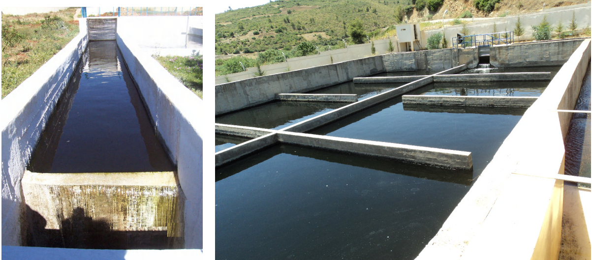
Photo III.7 : Bassin de chloration de la STEP de la ville de Médéa
