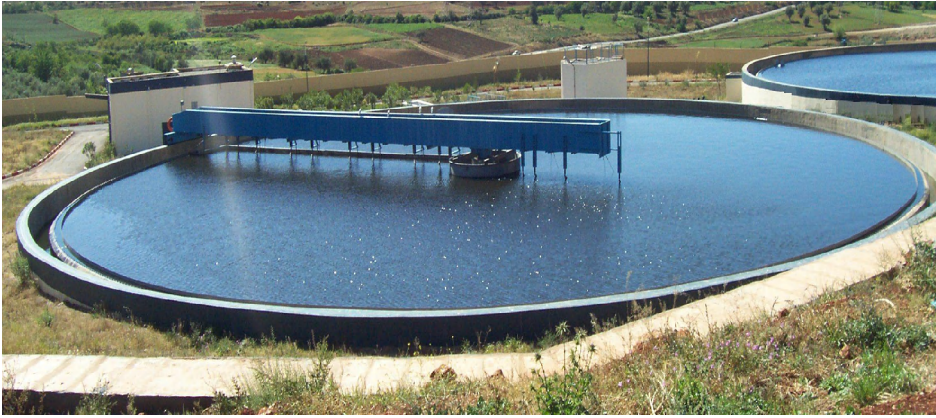
Photo III.6 : Décantation secondaire de la STEP de la ville de Médéa
