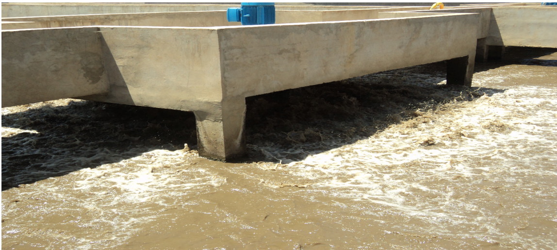
Photo III.5 : Bassins d'aération de la STEP de la ville de Médéa
