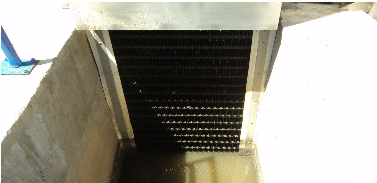
Photo III.3 : Grilles mécanisées fine de la STEP de la ville de Médéa
