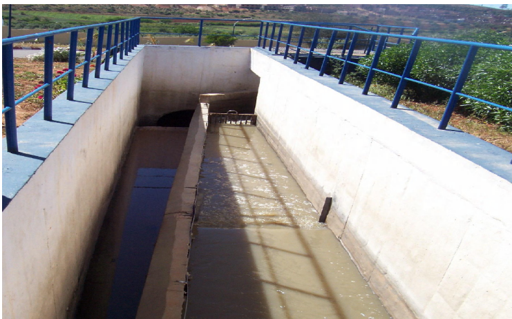
Photo III.2 : Déversoir d'orage de la STEP de la ville de Médéa
