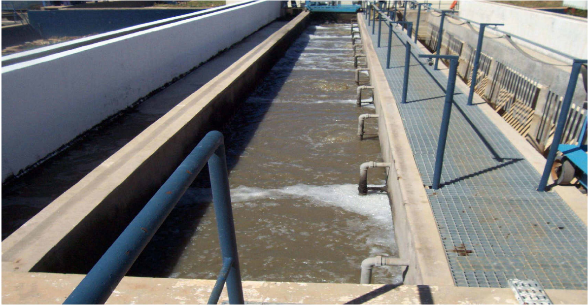
Photo III.4 : Dessableurs déshuileur de la STEP de la ville de Médéa
