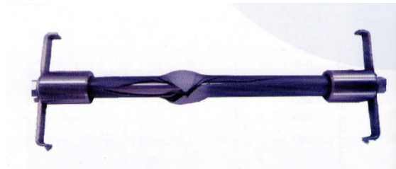
Photos.1.VI : effet de coupe de bélier sur la conduite
