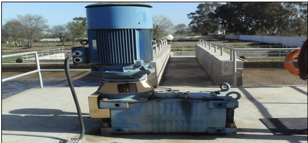
Figure V.8 : Aérateurs du compartiment aérobie.
