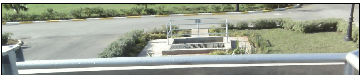
Figure V.4 : Le dégrilleur grossier.
