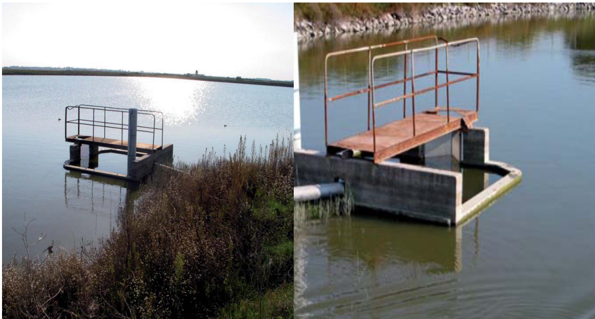
Figure I.03: Vue du traitement tertiaire des eaux usées par lagunage et des pompes d'irrigation à Noirmoutier (installation exploitée par la Saur).
