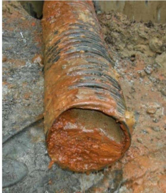
Photo IV-3 drains enterrés en matière plastique (P.V.C)
