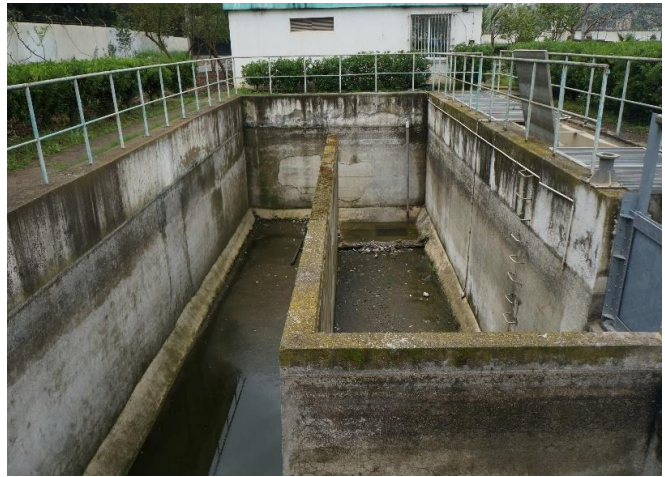
Figure III.9 : Bassin de chloration
