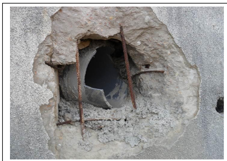
Figure N°II.32 : rejet des eaux pluviales (DN315 PVC)
