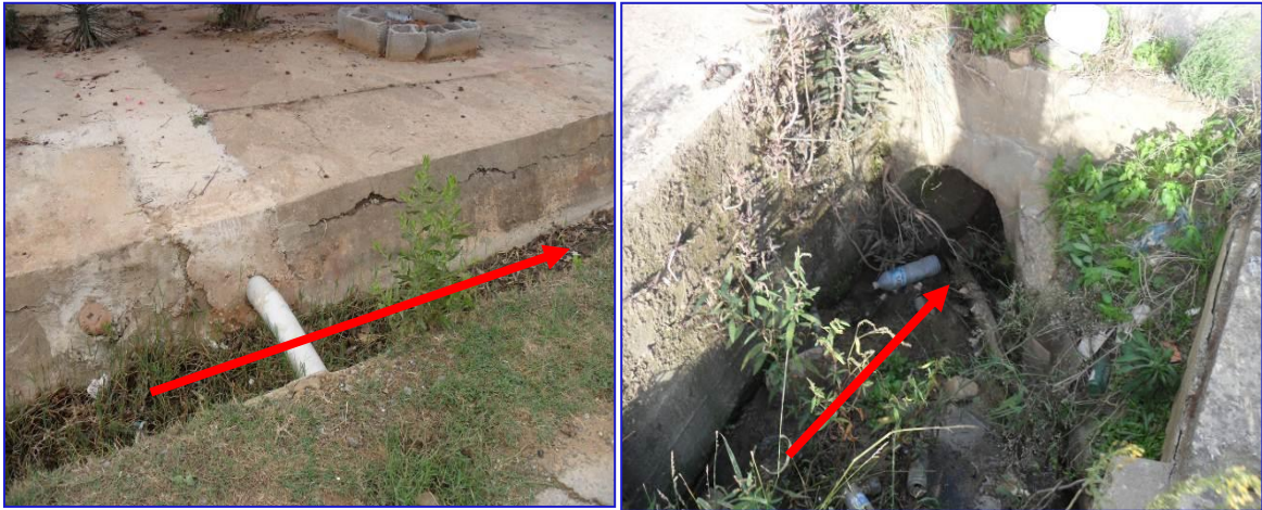
Figure N°II.28 -29: vue générale du caniveau rectangulaire
