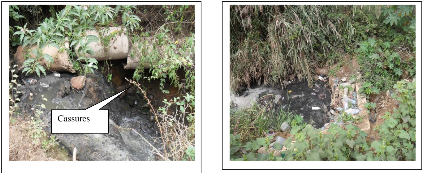
Figure N°II.36 : rejet des eaux usées causé par la cassure du collecteur DN800 béton
