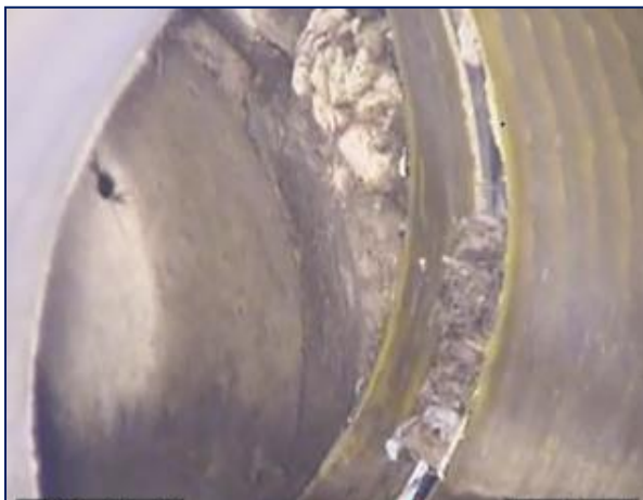
Fig N°II.21 : Vue Aval de la conduite en PEHD ANNELE DN 400(Situation :EU/CS-M32/ R482)
