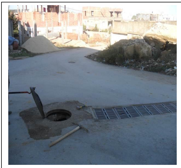
Fig n°II.42 : vue extérieure du regard
