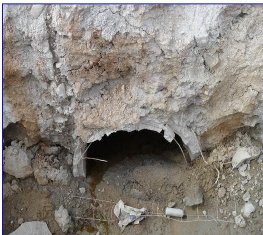
Figure II.1: rejet N°1 des eaux pluviales dans la mer
