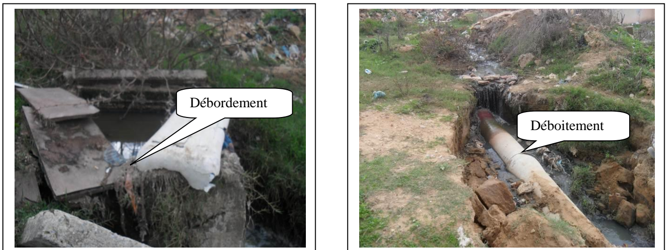
Figure N°II37 : Diversement des eaux usées dans le milieu naturel (réseau d'assainissement endommagé)
