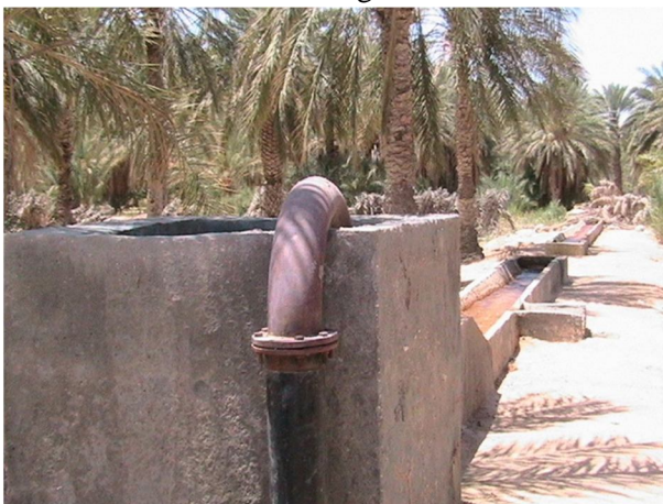
Fig.36 : récepteur d'eau d'un forage du CT
