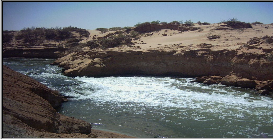
Fig. 46 : Destruction des berges du canal en sable à cause des turbulences
