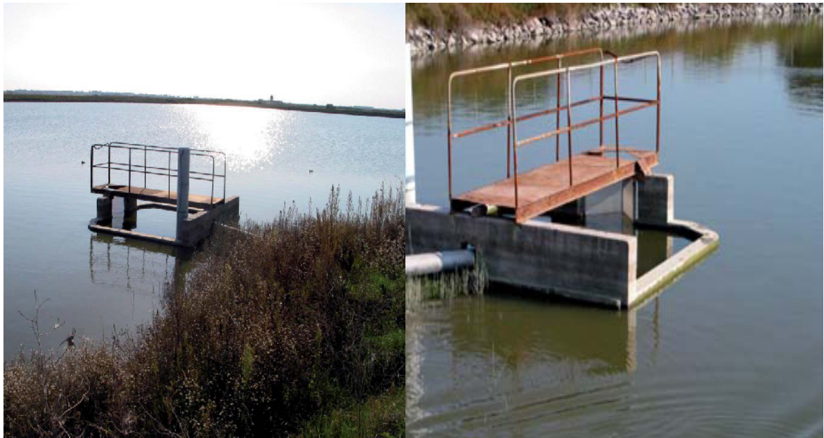
Figure I.03: Vue du traitement tertiaire des eaux usées par lagunage et des pompes d'irrigation à Noirmoutier (installation exploitée par la Saur).
