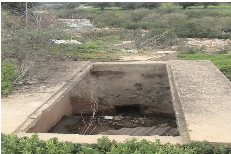
Figure III. 6.Regard ouvert proche au point de rejet
