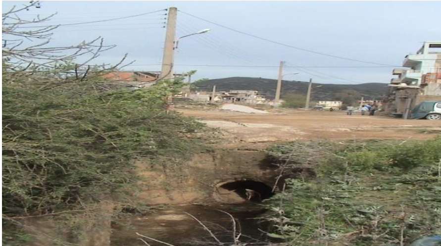
Figure III. 1. L'entrée de la conduite
