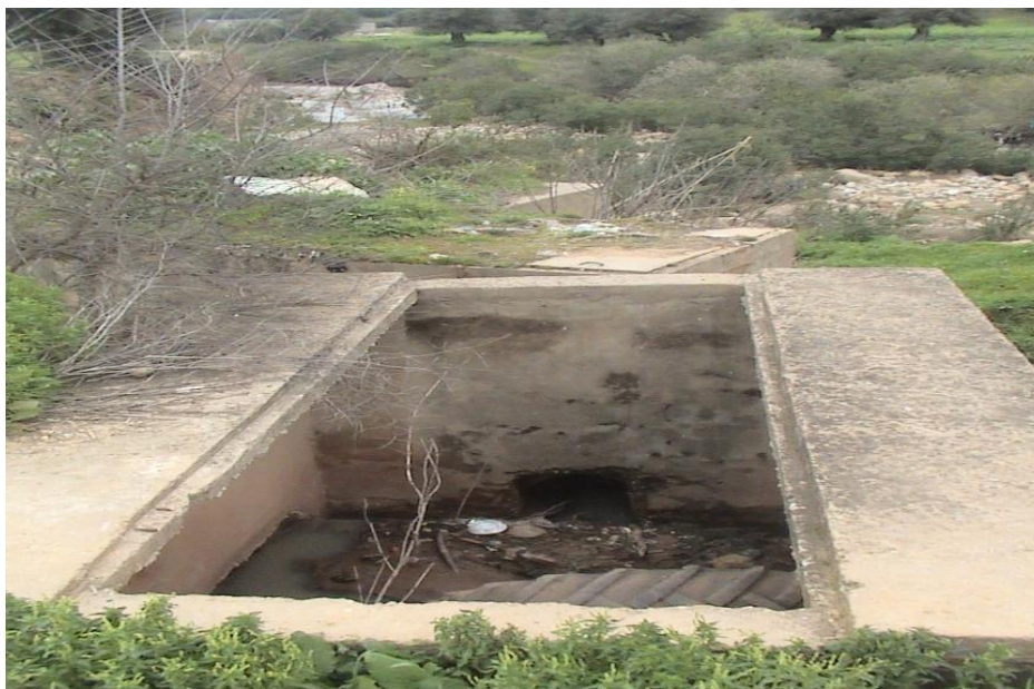
Figure III. 6.Regard ouvert proche au point de rejet
