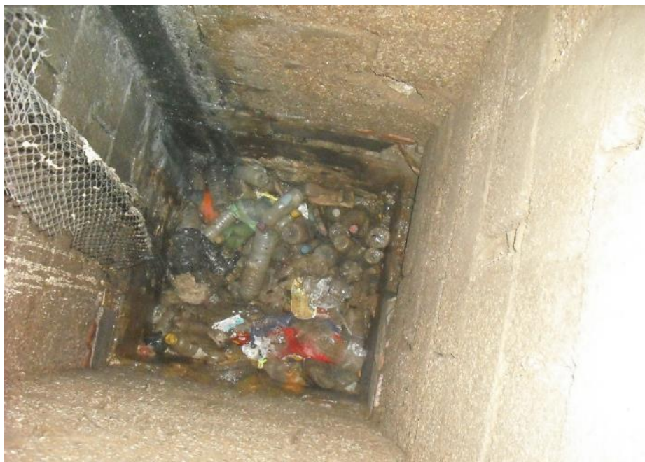
Figure III-11 : Regard dont les conduites amont et aval sont masquées par les déchets. (Absence d'échelle de descente) 27-07-2016.
