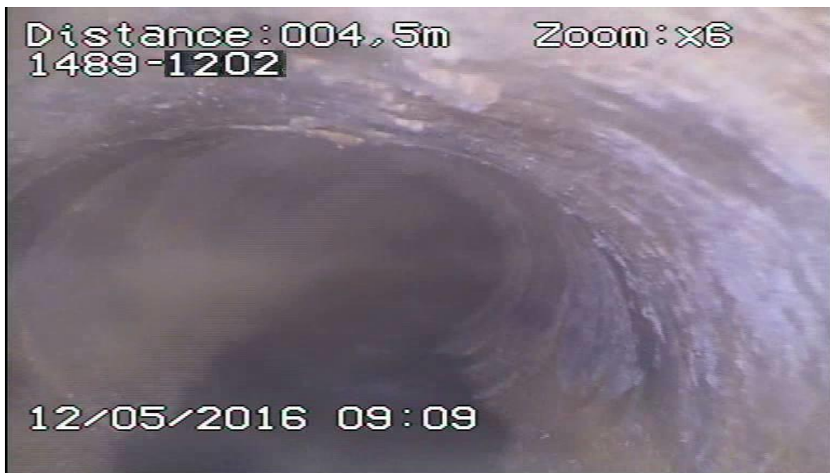
Figure III-7 : Effondrement de la conduite
