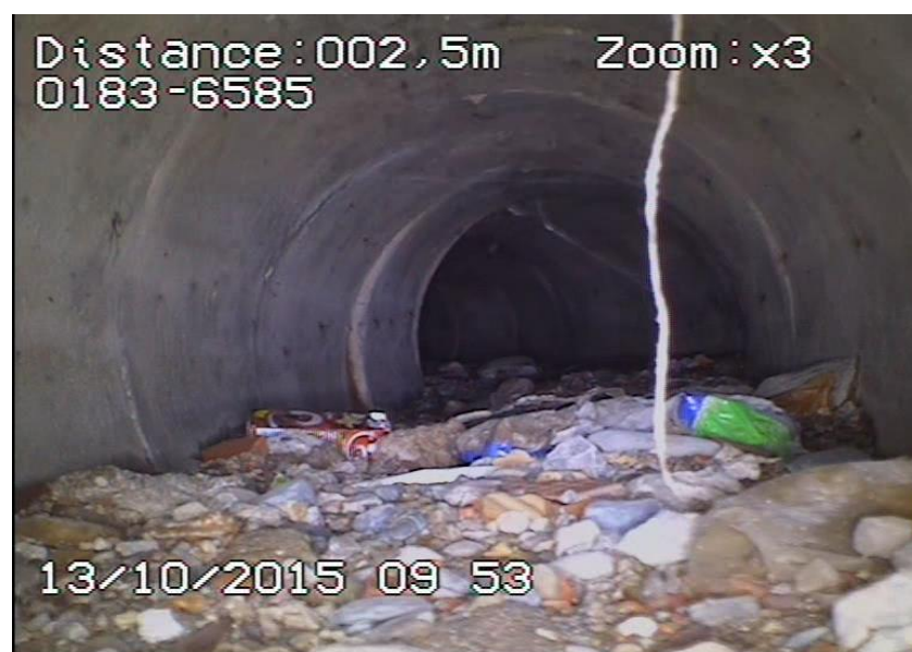
Figure III-4 : conduite encombrée par des déchets ménagers et des gravats
