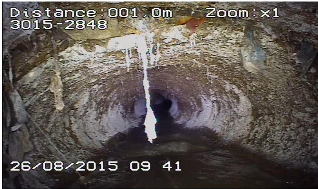
Figure III-8 : Corrosion des parois en béton d'une conduite.
