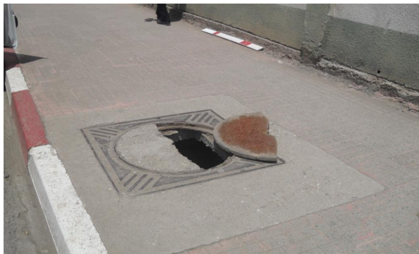
Figure III-9 : Etat dégradé des tampons des regards.27-05-2016.
