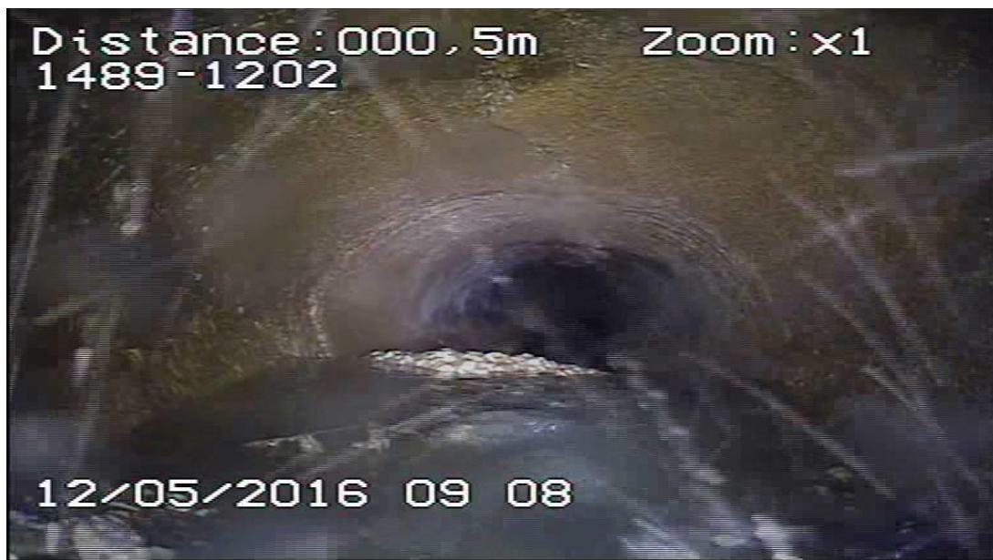
Figure III-3 : Dépôt dans la conduite, stagnation des eaux et fissuration sur la génératrice supérieure
