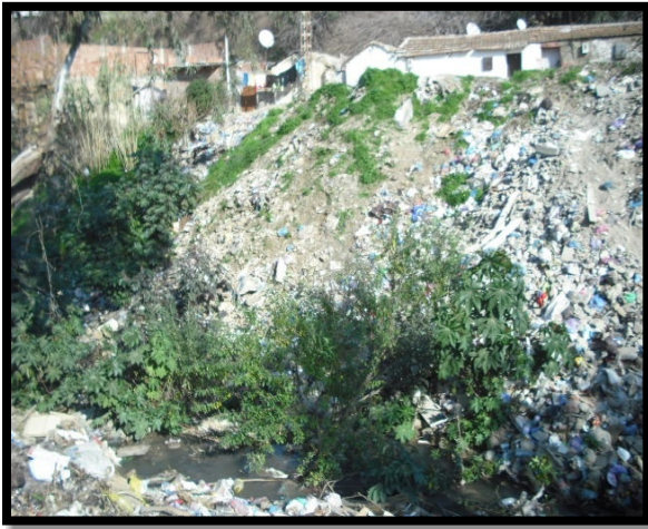
Figure II-18 Violation du lit par des rejets et déchets (06/20016)
