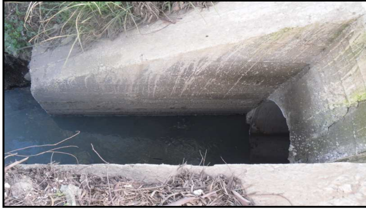
Figure N°III.2 : Rejet Ø800 de l'école nationale préparatoire des élèves ingénieurs et Ferme Mskifa
