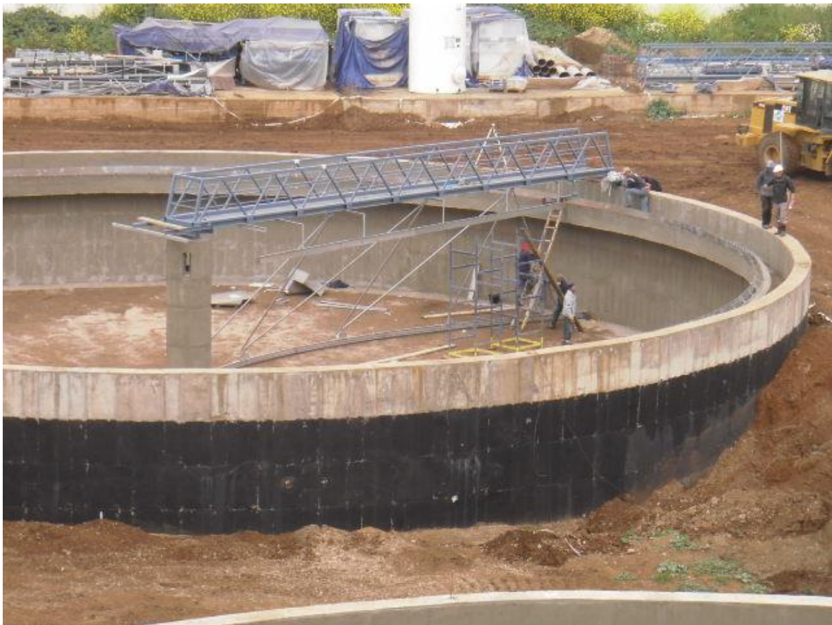
Fig. II.3. Photo de décanteur primaire
