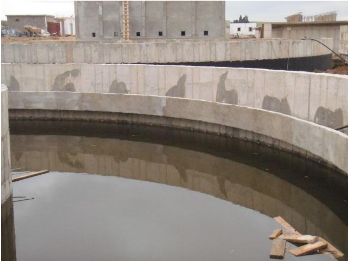
Fig.II.4. photo du clarificateur
