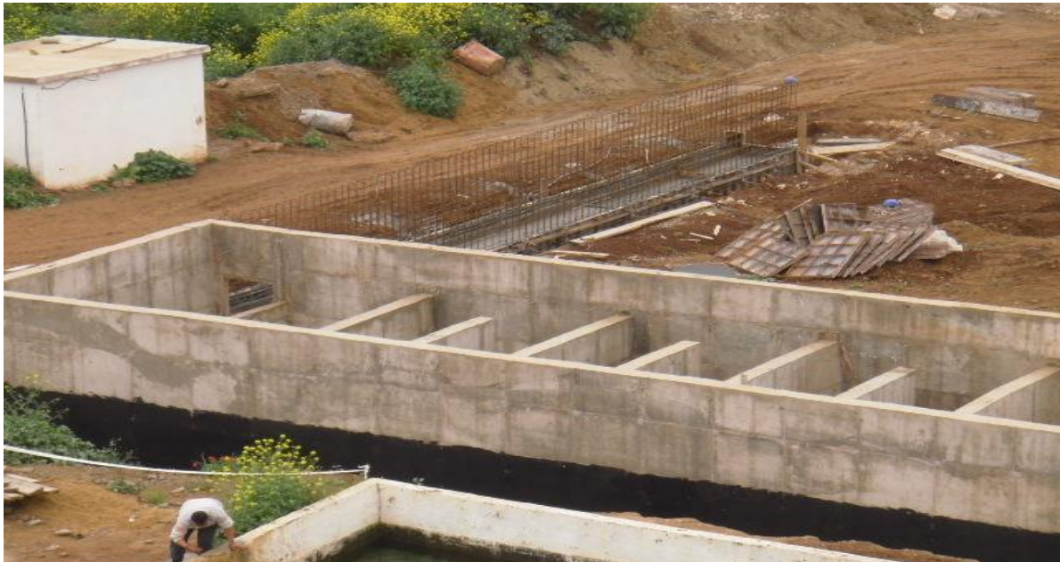
Fig.II .5 : photo du bassin de désinfection
