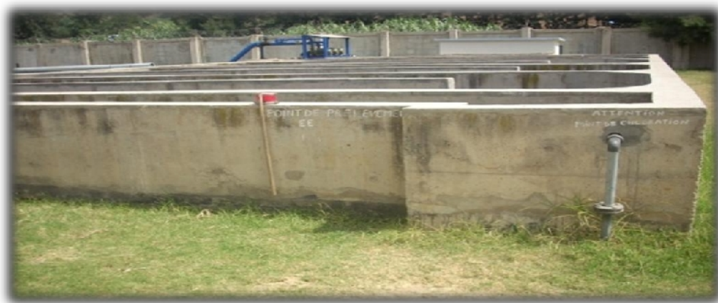
Figure II-9 : Canal de comptage et désinfection (chloration)
