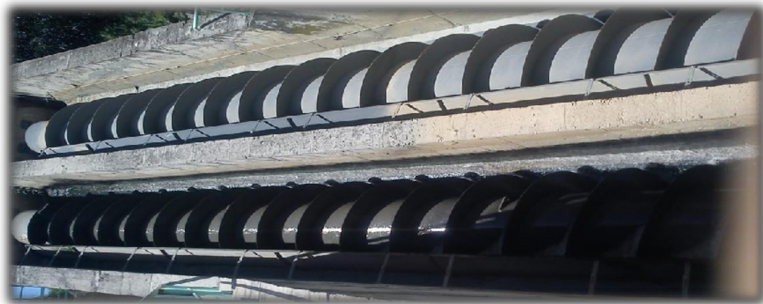
Figure II-4 : Relevage des eaux par vis d'Archimède
