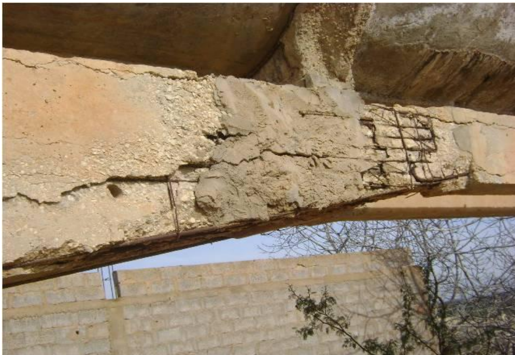
Figure N° 9: Vieillissement du béton et apparition des armatures et corrosion des armatures de l'ouvrage hydraulique du réseau d'irrigation de la plaine de Habra (traversée de l'oued)
