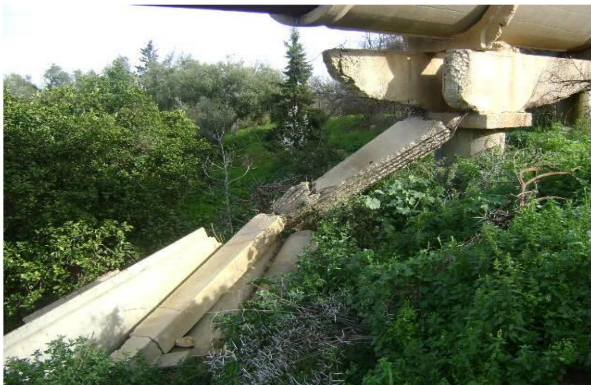
Figure N°10 : dégradation des poutres porteuses des canaux
