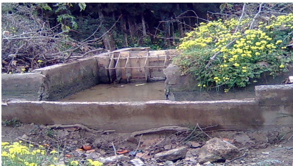
Figure 5 : canal tertiaire en mauvais état.
