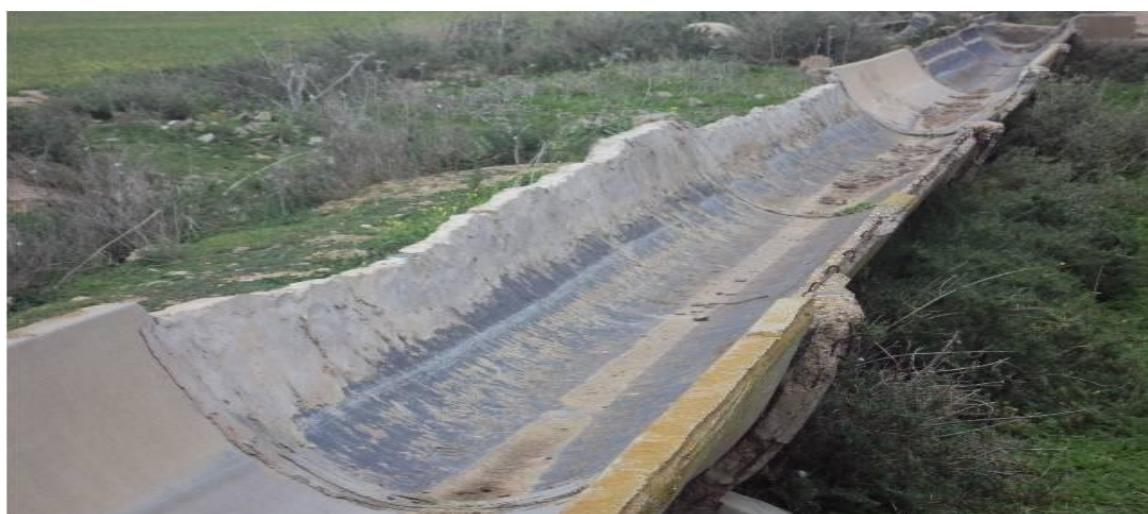
Figure N° 11 : Dégradation des canaux
