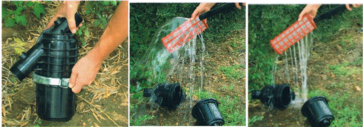
Fig. V.10. Nettoyage filtre à tamis
