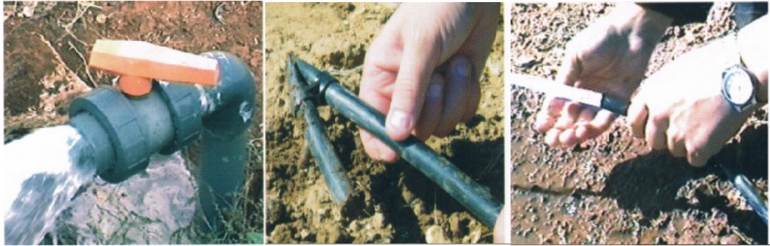
Fig. V.12. Purge du réseau
