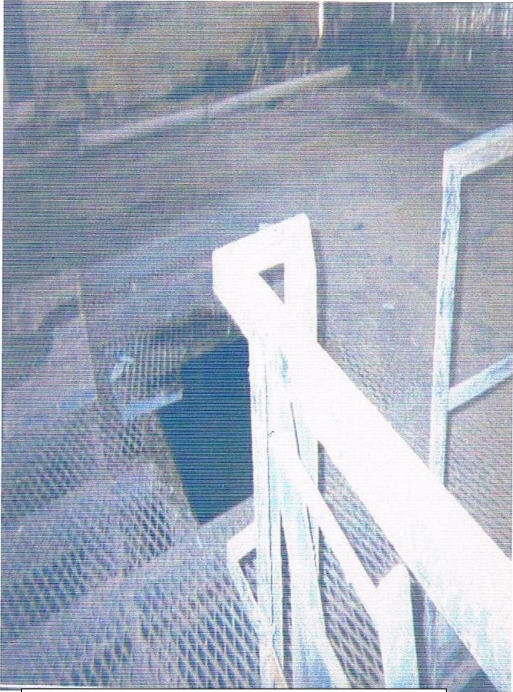
Deterioration des grilles et leur peinture
