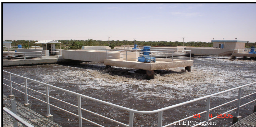
Figure IV-04: Bassin d aération
