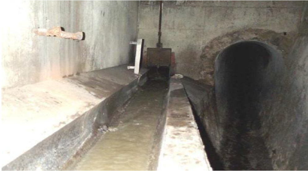
Figure VI.6 : Déversoir à seuil latéral
