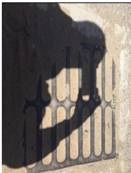
Figure II.9 : obstruction de la bouche la D'égouts par du sable
