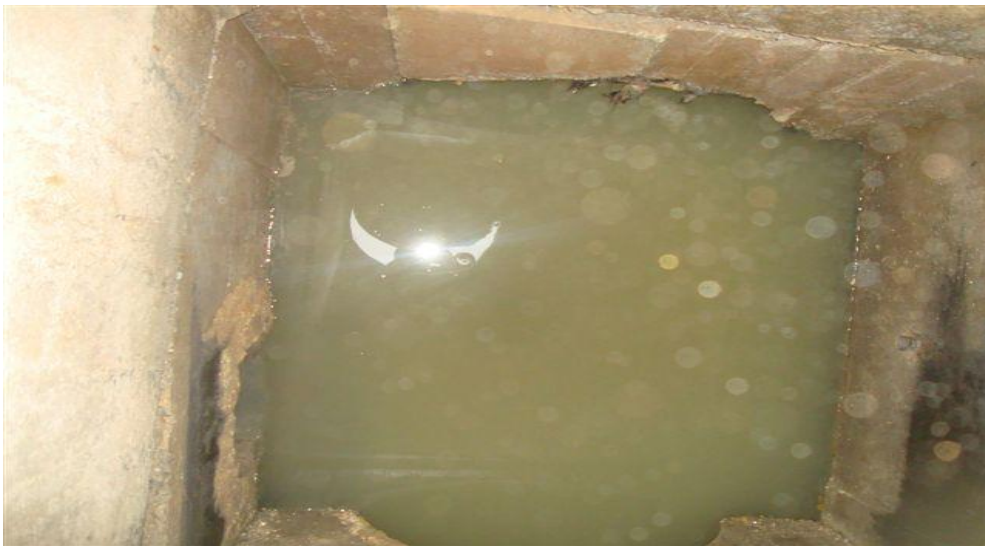
Figure II.6 : stagnation des eaux usées dans le regard
