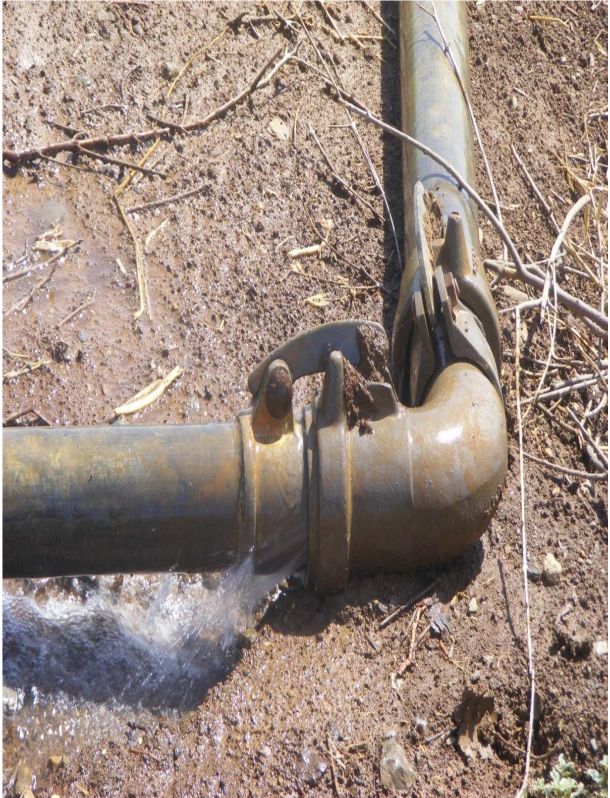
Figure 16: perte d'eau au niveau du raccordement entre rampe et porte rampe
