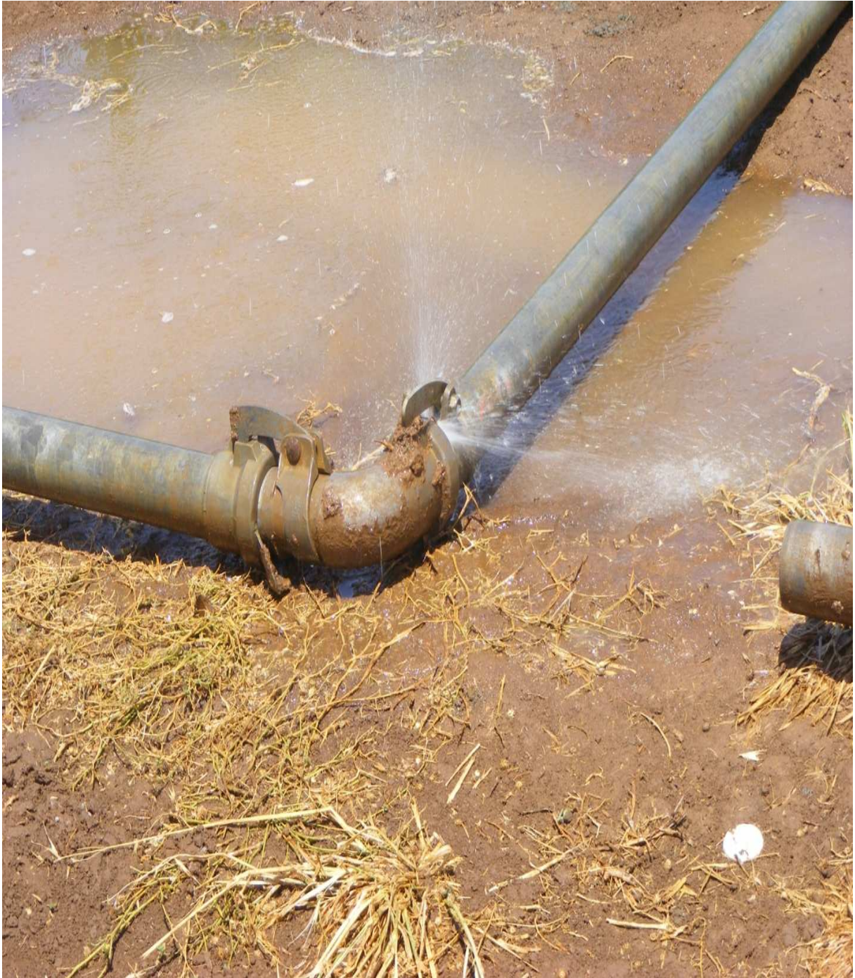
Figure17: perte d'eau au niveau des raccords
