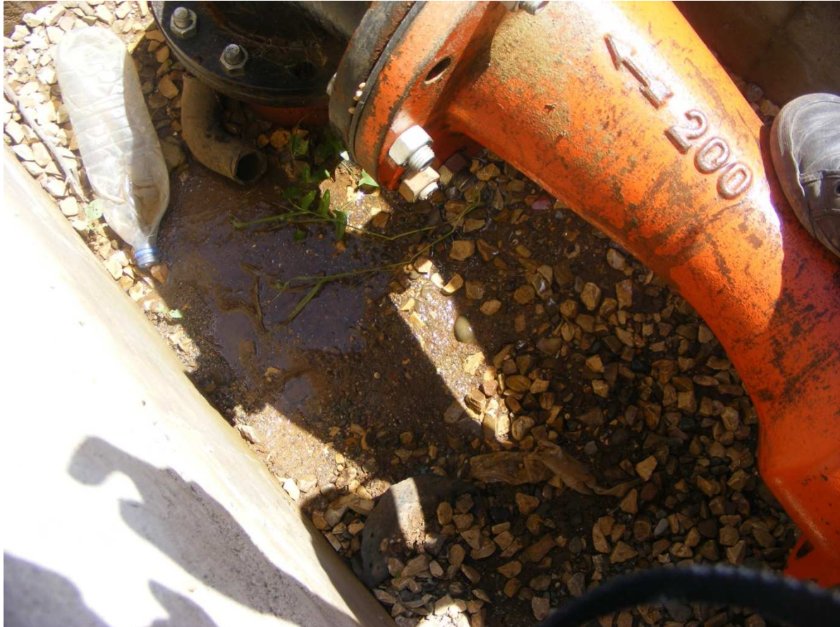
Figure 15 : Perte d'eau au niveau de la borne
