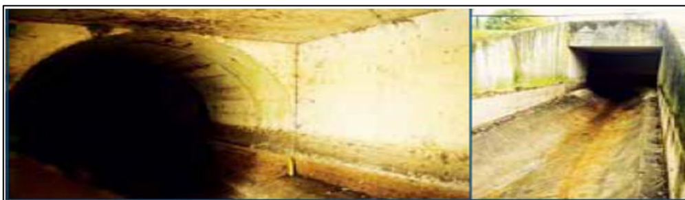
Figure I.23. Couverture complète d'un cours d'eau. Rigole de Guyancourt dans le département des Yvelines.
