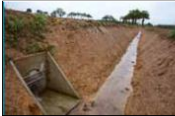
Figure I.20. Rectification, recalibrage et drainage sur le ruisseau de l'étang à Availles Limouzine. (source : Michel Bramard,(86))
