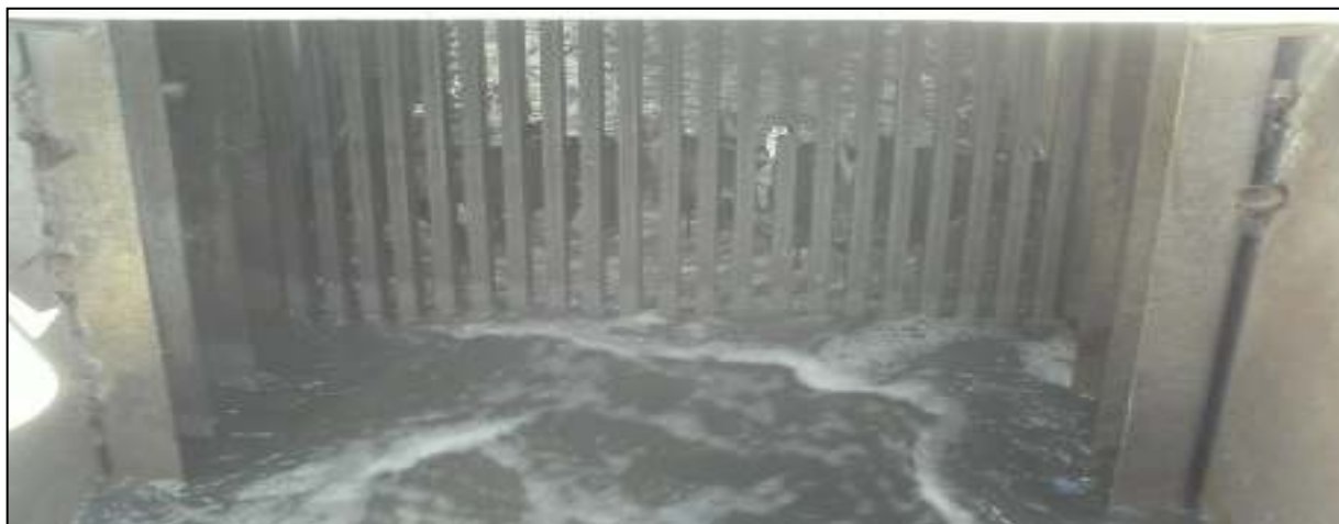
Figure II.4 : Le dégrilleur grossier.
