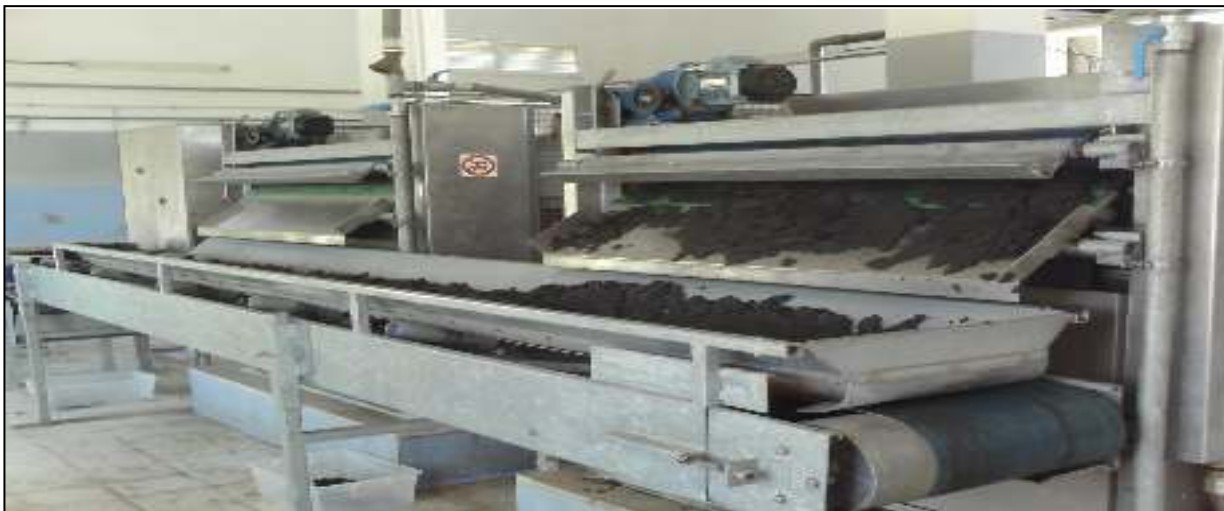
Figure II.12 : Unité de déshydratation.
