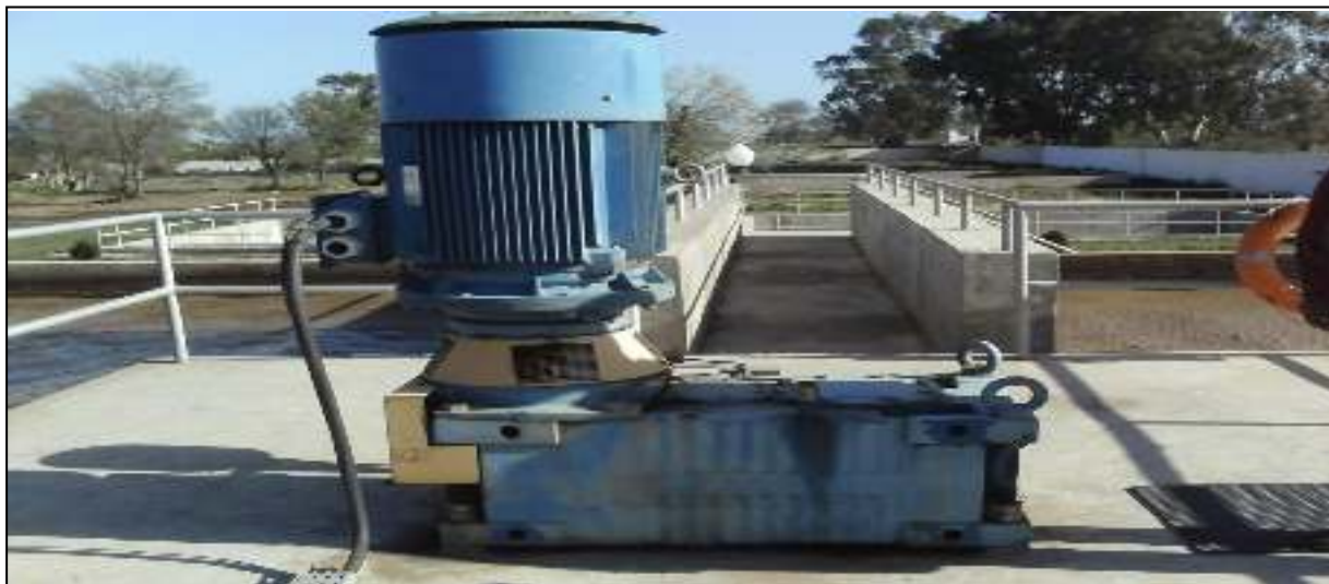
Figure II.8 : Aérateurs du compartiment aérobie.
