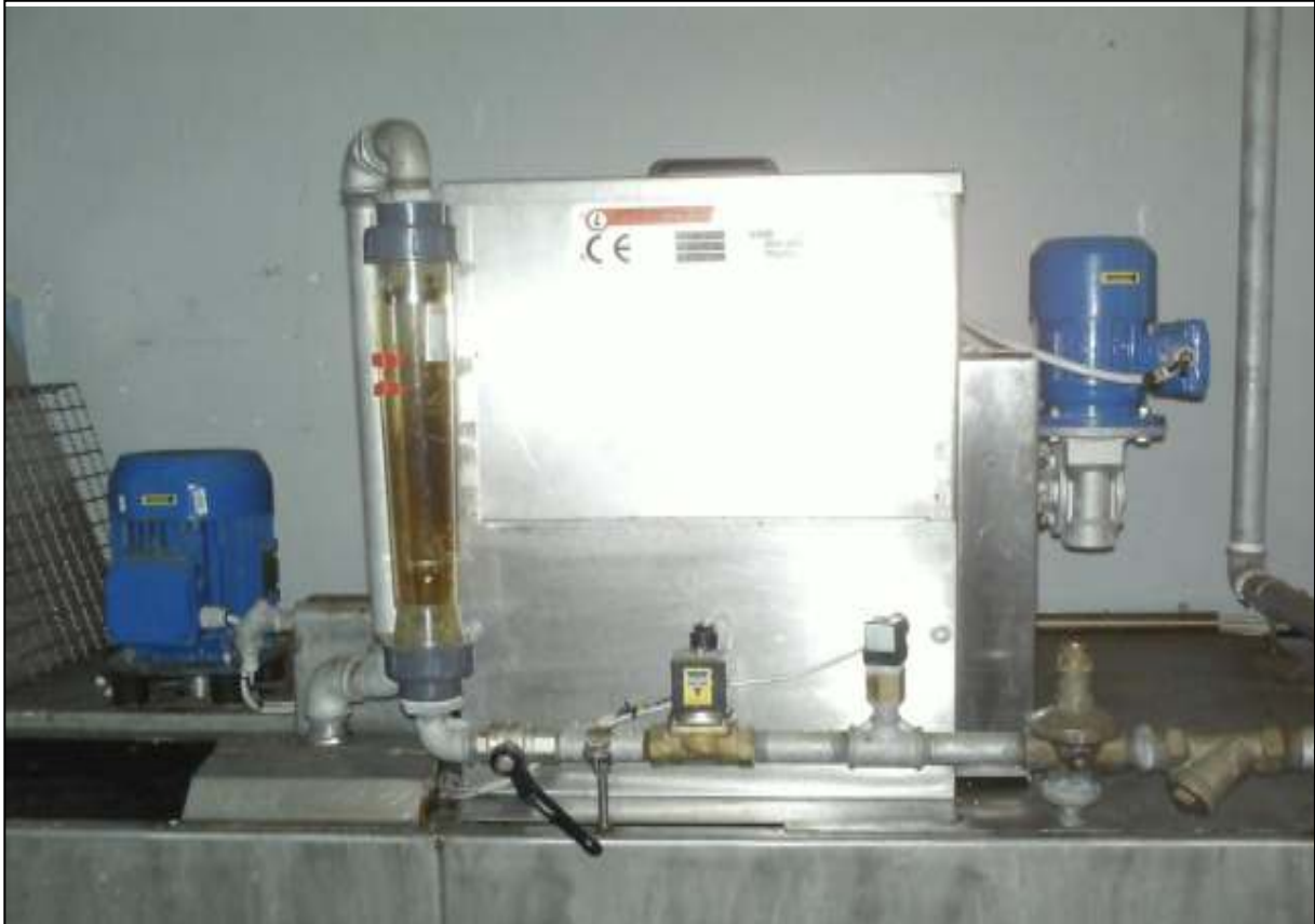
Figure II.13: Unité de préparation de polymère.
