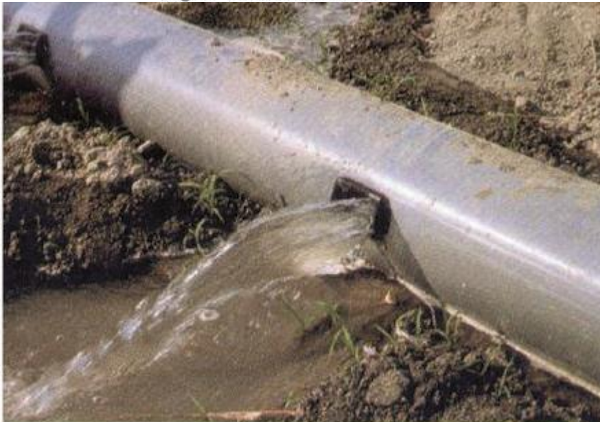
Figure 36:vannette coulissante réglant le débit dans la raie
