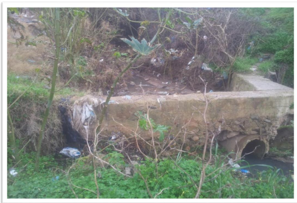
Figure IV. 2: Deuxième ouvrage de rejet vers la mer méditerranée (Mars, 2018)
