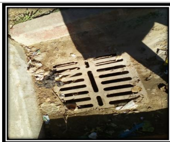
Figure III.2. Représente l'état dégradé d'une bouche d'égout ; (07/05/2018)
