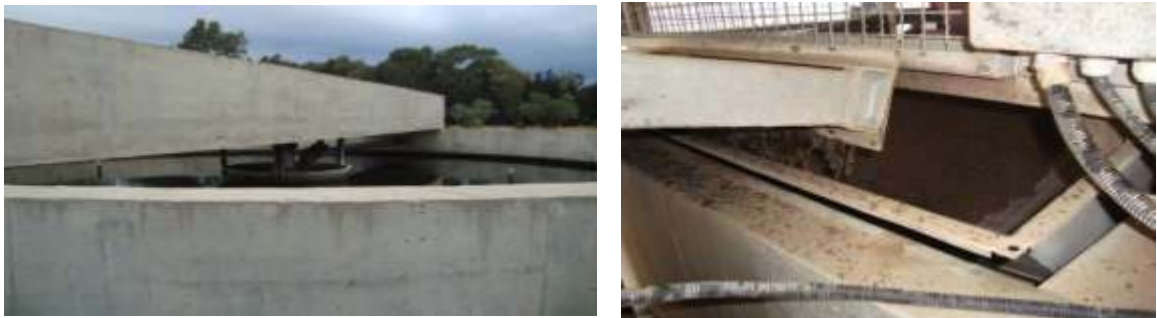
Figure II-13: Epaississeur de boues (à gauche);Déshydrations mécanique (à droite) de la STEP de la ville de Hadjout
