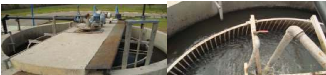
Figure II-5: Dessablage / déshuilage de la STEP de la ville de Hadjout
