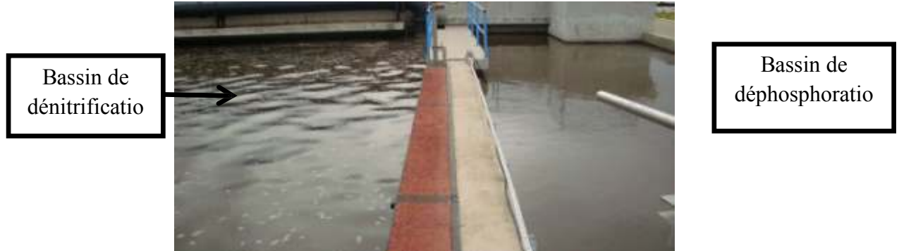
Figure II-7: Les bassins de déphosphoration- dénitrification
