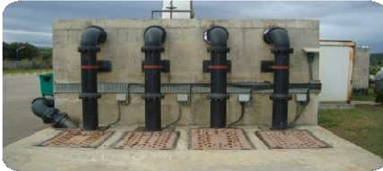
Figure II-3 : Station de relevage de la STEP de la ville de Hadjout
