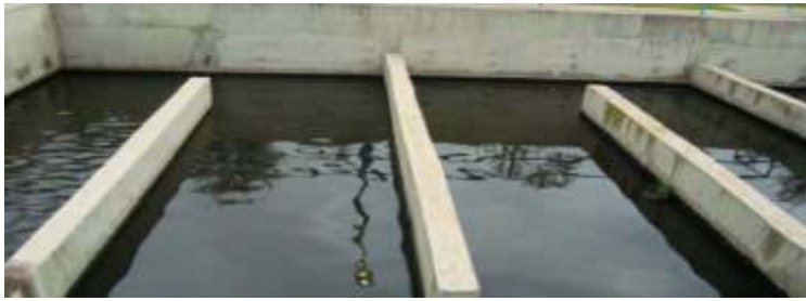
Figure II-12: Bassin de désinfection
