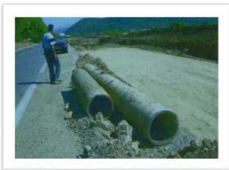
FigureN°V.1 : Etat de la conduite d'irrigation après élargissement de la route nationale R.N 43. Conduite en amiante ciment \phi 400mm.
