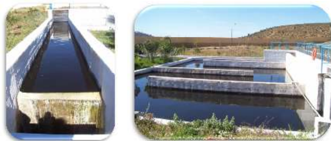
Figure.III.7. Bassin de chloration de la STEP de la ville de Maghnia
