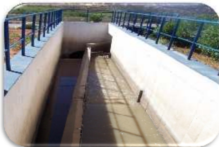
Figure.III.2. Déversoir d'orage de la STEP de la ville de Maghnia
