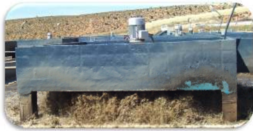
Figure.III.5. Bassin d'aération de la STEP de la ville de Maghnia
