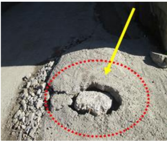
Figure (II-07) : Regard avec la présence d'un tampon cassé au voisinage d'une école primaire
