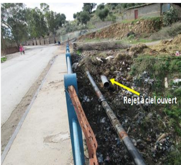
Figure (II-09) : Rejet à ciel ouvert juste à cote d'un pont de Oued Mechaab, présence d'une conduite AEP et une décharge
