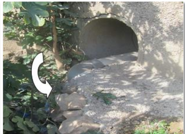
Figure (II-02) : Passage d'une conduite d'irrigation à l'intérieur d'un Oued des eaux usées.
