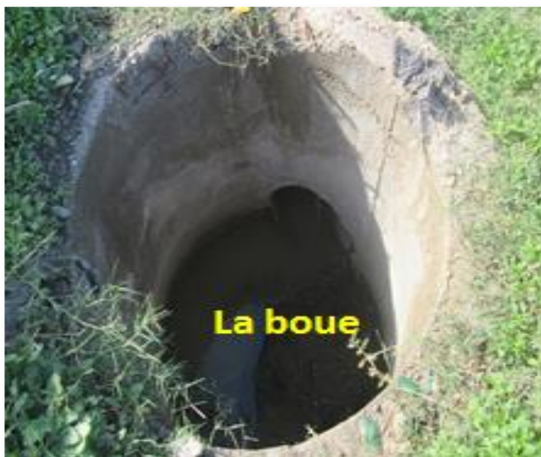
Figure (II-03) : Présence d'un regard colmaté favorisons l'écoulement des eaux usées à ciel ouvert.
