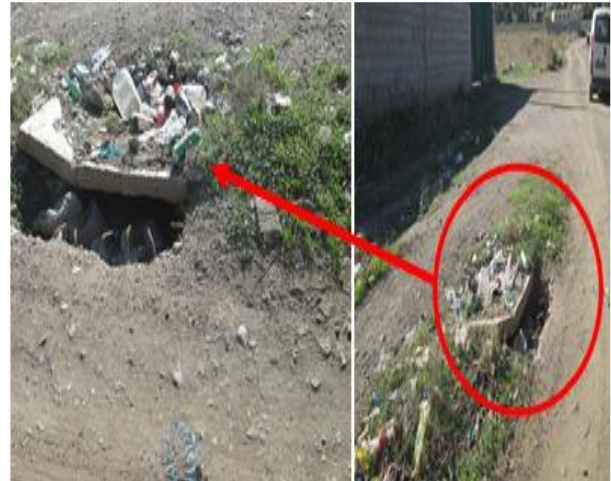
Figure (II-06) : Regard endommagé et risque de colmatages par les déchets extérieurs
