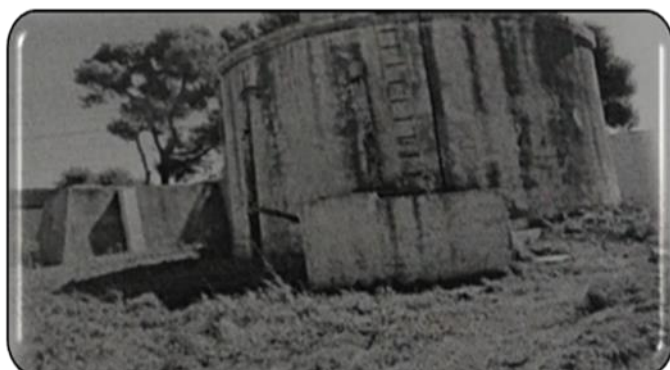
Figure I.6 : réservoir d'eau de 250 m 3
