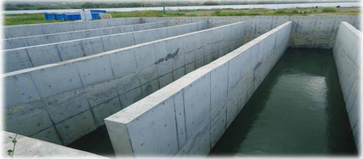
Figure III-06- Bassin de désinfection
