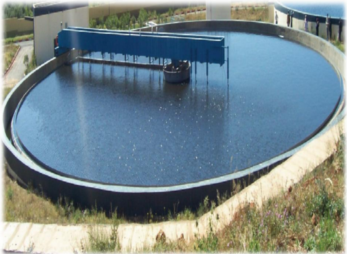
Figure III-06- : décanteur secondaire (clarificateur)
