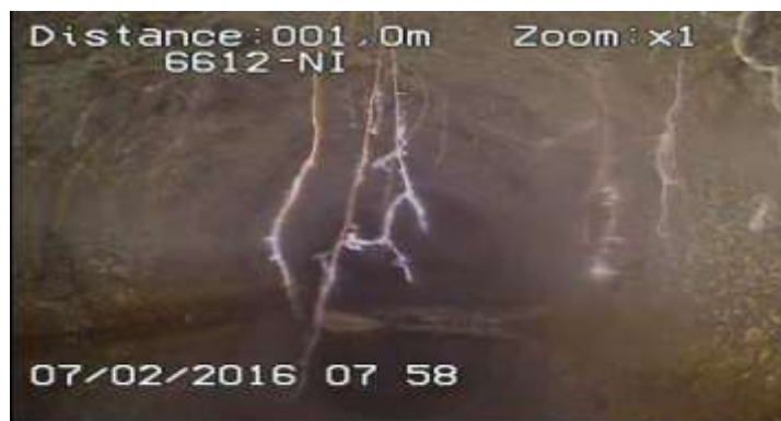
Figure II. 3: la pénétration des racines dans les canalisations (SCE, ONA).
