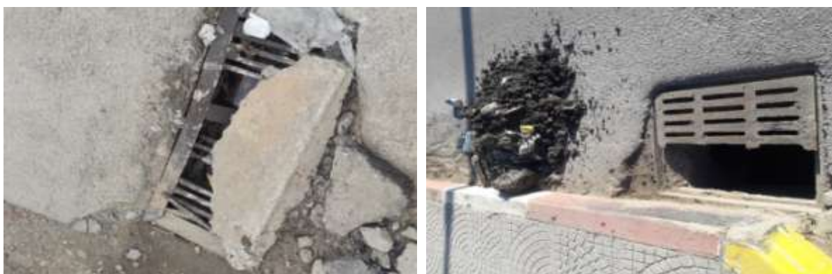
Figure II. 5: Etat des caniveaux: des grilles déformées et cassées (prises par l'étudiante (26/08/2019))
