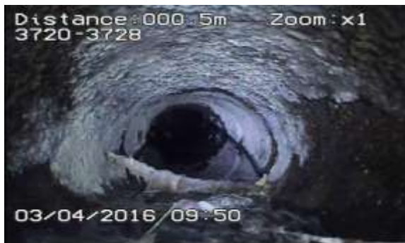
Dégradation de surface :
