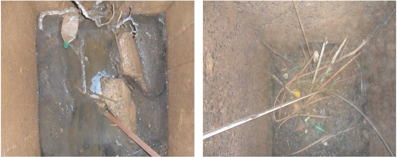
Figure II.2 : Colmatage des regards (Besoin de curage R13-R41). [1]
