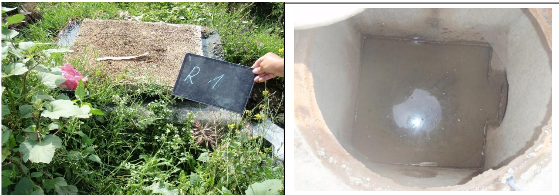
Figure II.3 Regard en bon état
