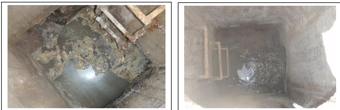
Figure II.4 Regard en mauvais état (écoulement nul, regard à nettoyer)
