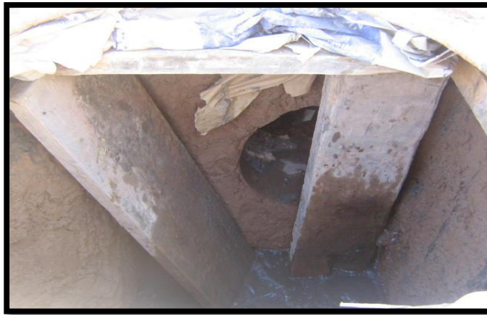
Figure II-1 Conduite (R187–R188) dégradée
