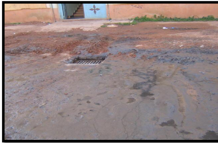
Figure II-2. Regard 223 débordement des eaux usées à l'entrée d'une habitation
