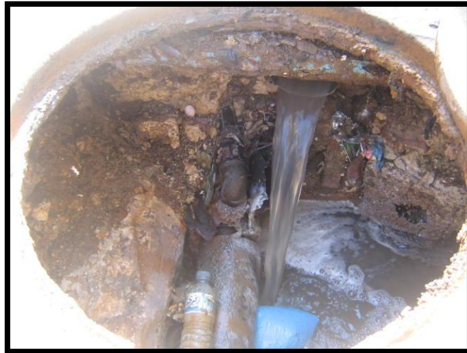
Figure II-6. Regard 182 endommagé avec présence des dépôts
