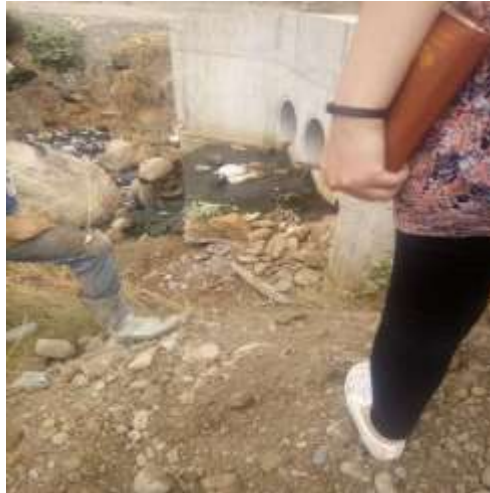
Figure II-2 : rejet direct des eaux usées vers un ravin (juillet 2019)
