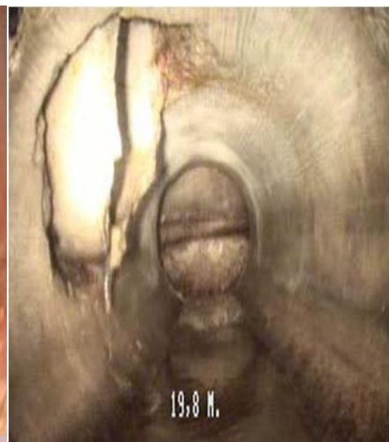
Figure II.6: Raccordement pénétrant et défectueux
