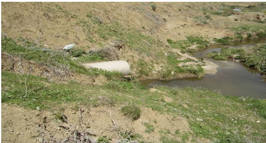
Figure II.1: Photos de rejet de la ville de Sidi Akkacha vers oued Allala
