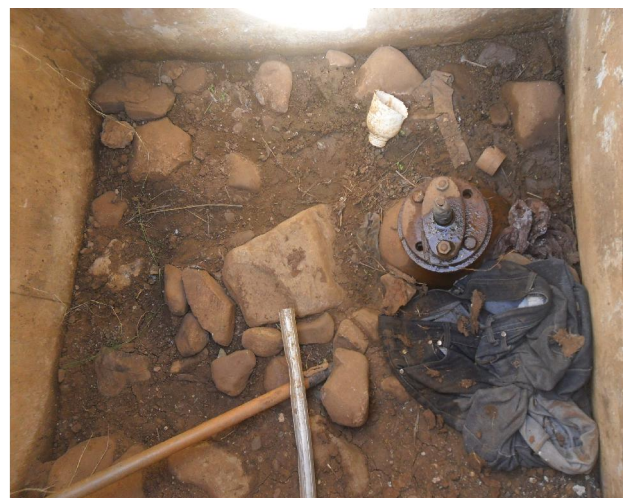
Figure 7 : Etat des vannes (ø200)
