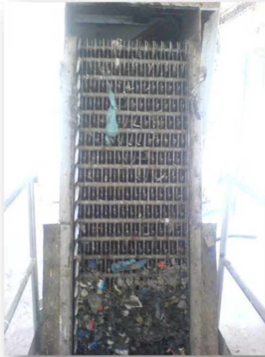
Photo II.1 : un Dégrillage mécanique.
