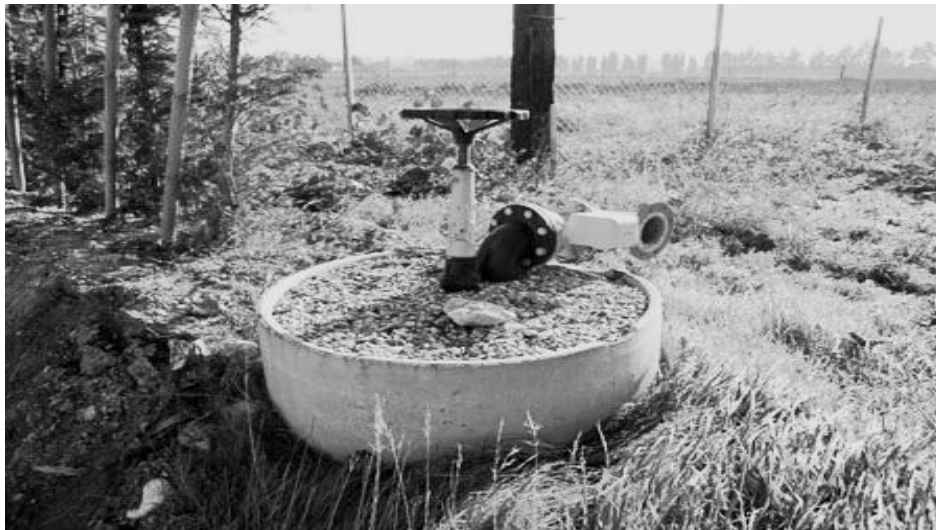
Figure IX.6 : photo d'une borne implantée dans une conduite en béton.
