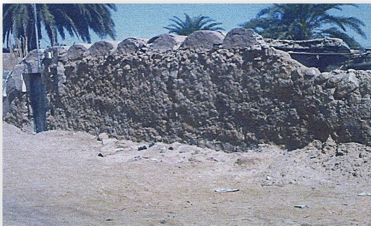
Photo (IV-9) : des maisons ruinées en Sidi Mastour
