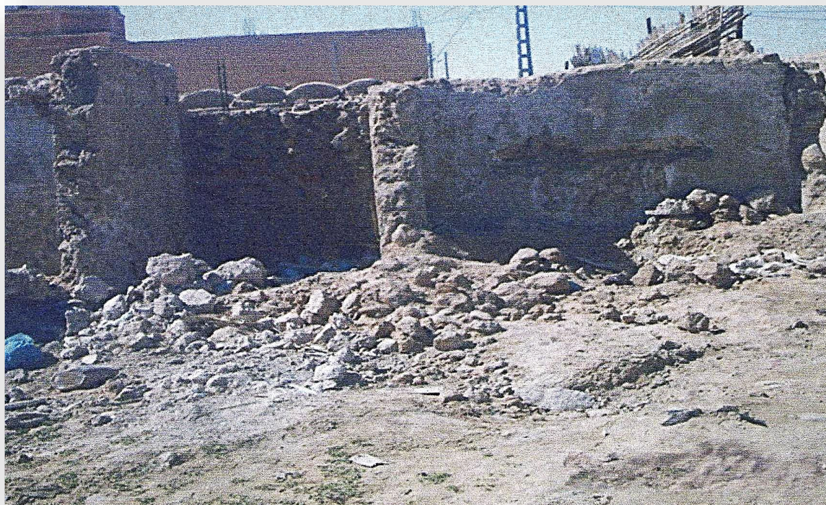
Photo (IV-8) : des maisons ruinées en Sidi Mastour
